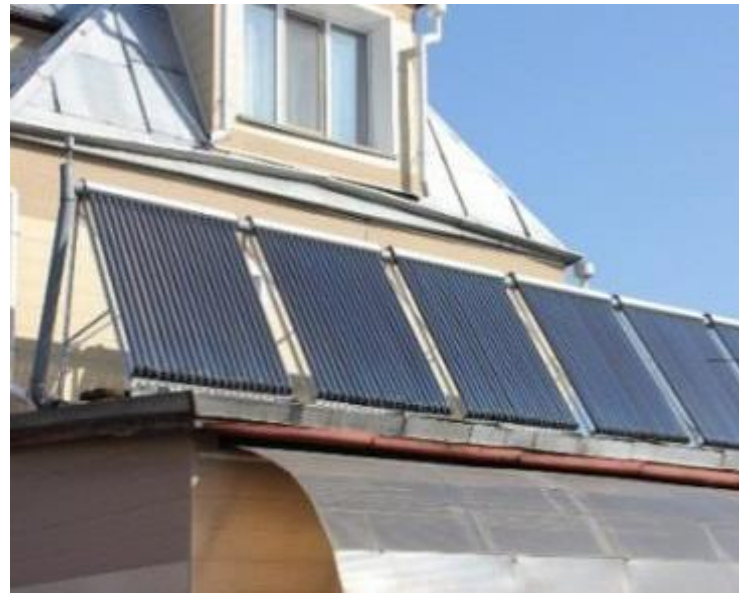
Группа солнечных коллекторов для энергообеспечения жилого дома (респ. Бурятия).
