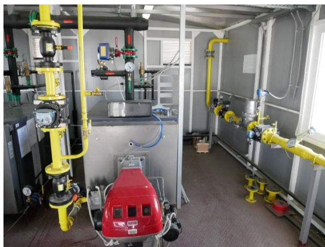
Рис. 1. Фотография реальной котельной
